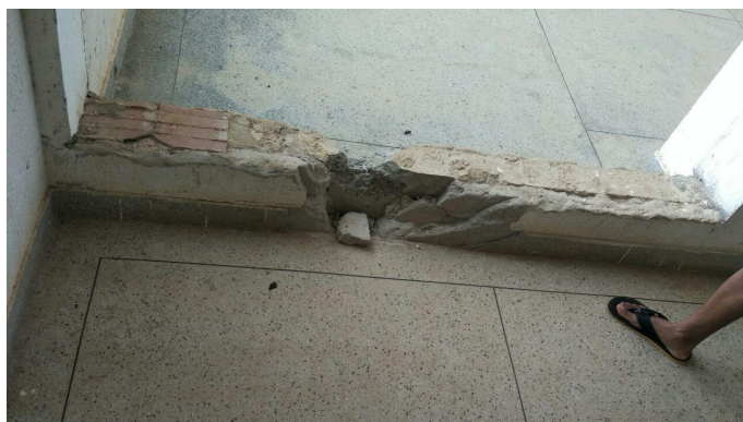
Figure 1. Falha de acessibilidade em corredor do bloco C - UFAL
