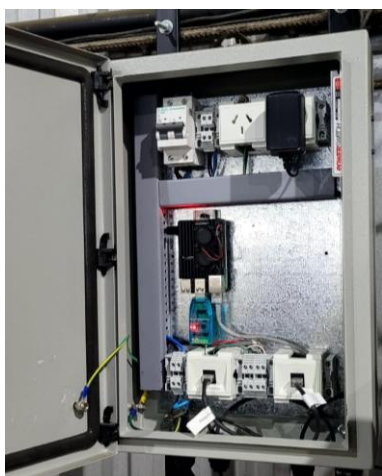
Fig. 6. Tablero que contiene al servidor central (Raspberry Pi).
