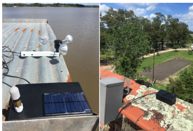
Figura 3. Instalação do hardware embarcado com nodo e gateway
